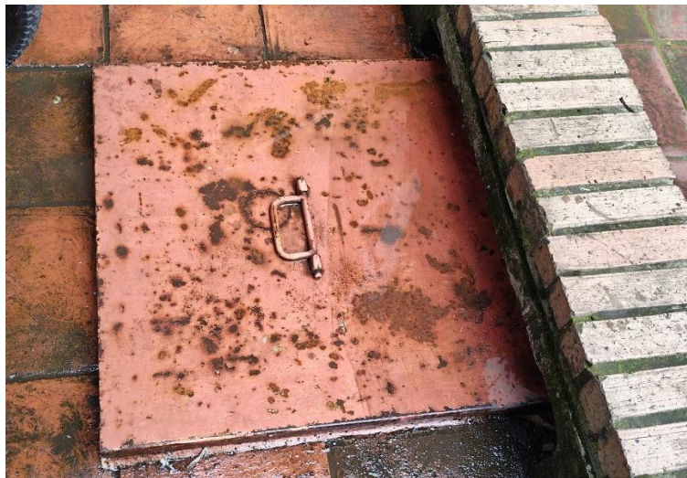
Lugar instalación Tapa Tanque Agua potable Casa Adjunta
